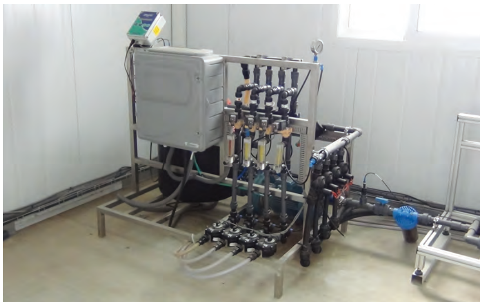
Εικόνα 2. Τυπική μονάδα αυτόματης αραιώσης πυκνών διαλυμάτων με κάδο ανάμειξης (κεφαλή υδρολίπανσης).
