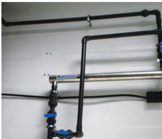
Εικόνα 8. Σύστημα απολύμανσης του θρεπτικού διαλύματος με UV.
